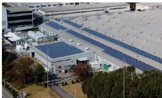
太陽光発電パネル 計311kW
